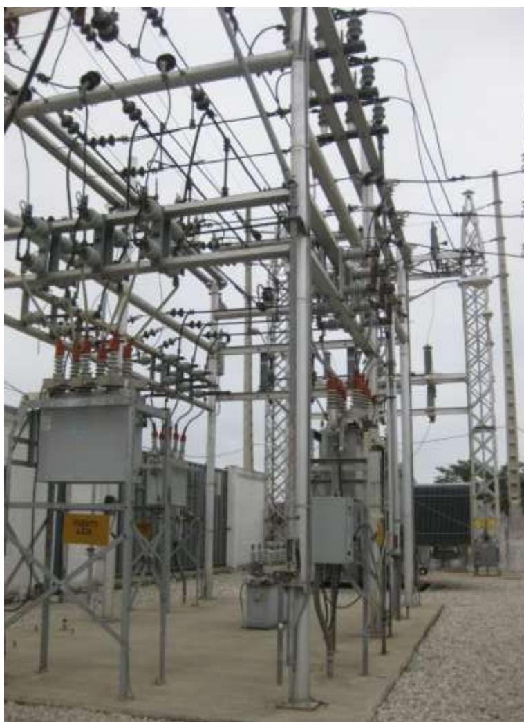
Figura 1.8 Patio de 13.8 KV.
