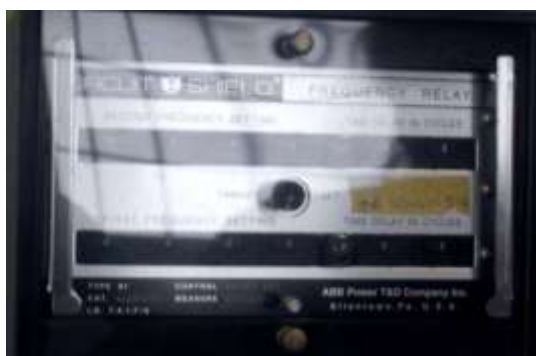
Figura 1.15 Relé ABB de la S/E para baja frecuencia.
