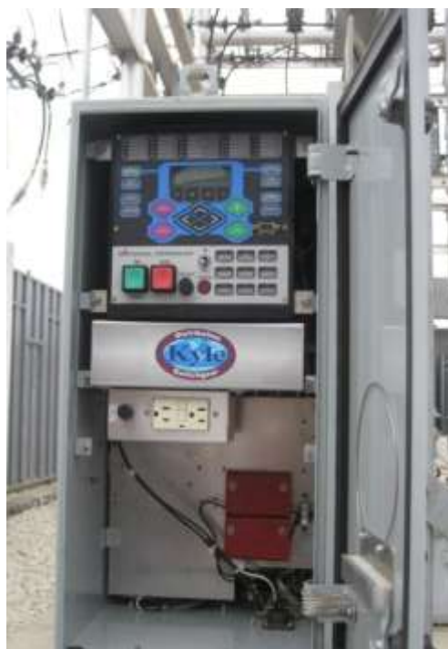
Figura 1.9 Vista interna del controlador Cooper forma 6.
