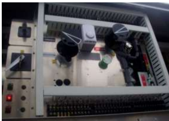
Figura 1.5 Vista interior del control del interruptor SF6.
