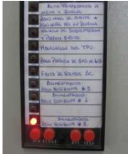
Figura 1.16 Panel de alarmas de la S/E Belo Horizonte.
