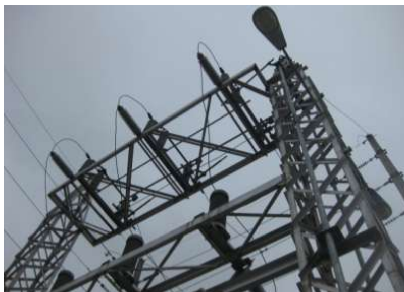
Figura 1.3 Vista de la estructura de 69 KV
