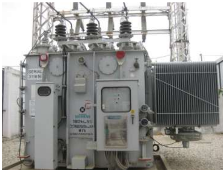
Figura 1.7 Transformador de potencia 67000/13800 V, marca SIEMENS
