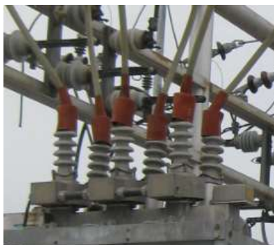
Figura 1.11 Transformadores de corriente en la S/E Belo Horizonte.
