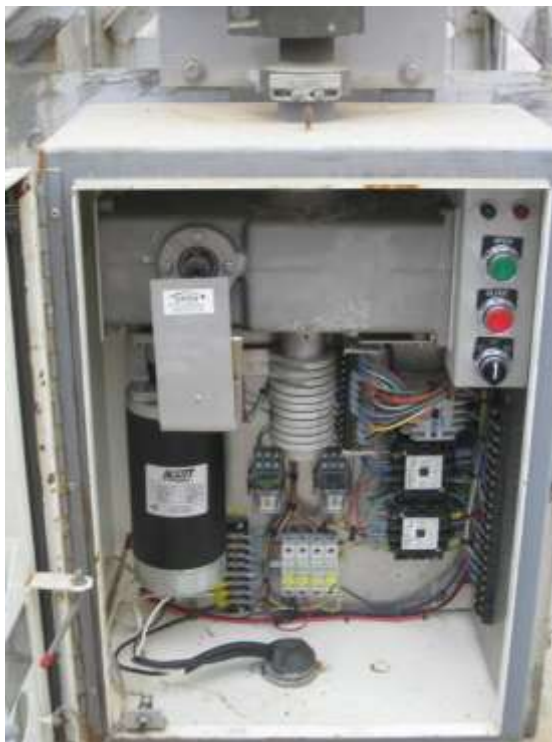
Figura 1.4 Controlador del motor del Seccionador de 69 KV.
