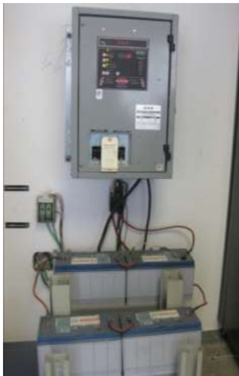
Figura 1.12 Cargador GNB y baterías Bosch.
