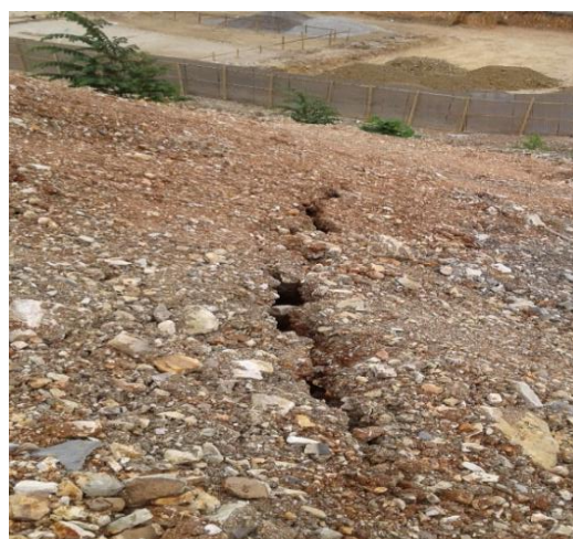
Figura 3. 4 Fisura del primer talud. Fuente: Suárez, C., Vicuña, B.,2018.
