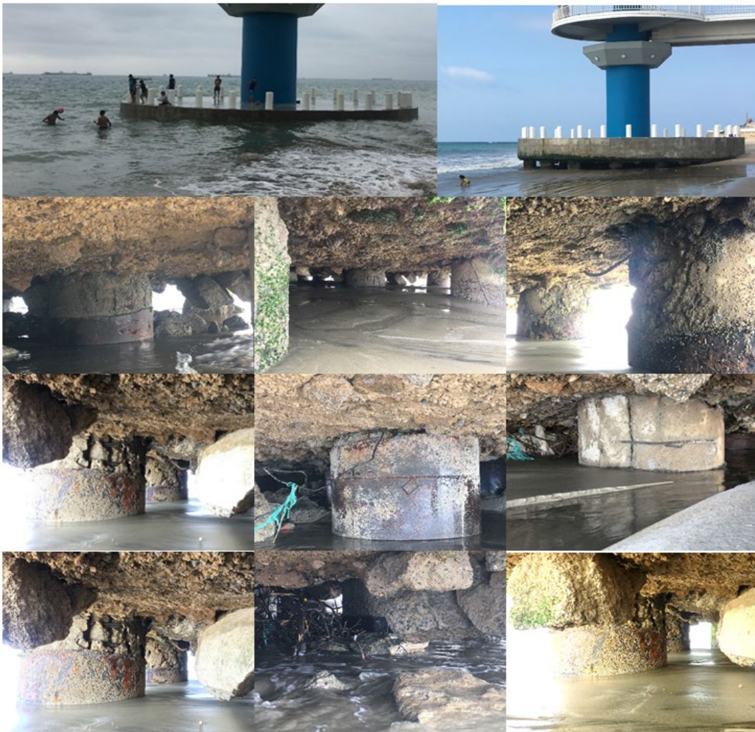
Ilustración 57.- Fotos de afectaciones en la base del Mirador
