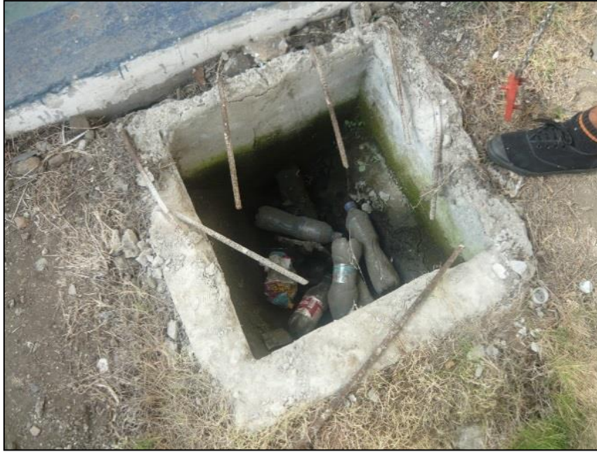
Figura 11.40 Caja de registro con presencia de basura
