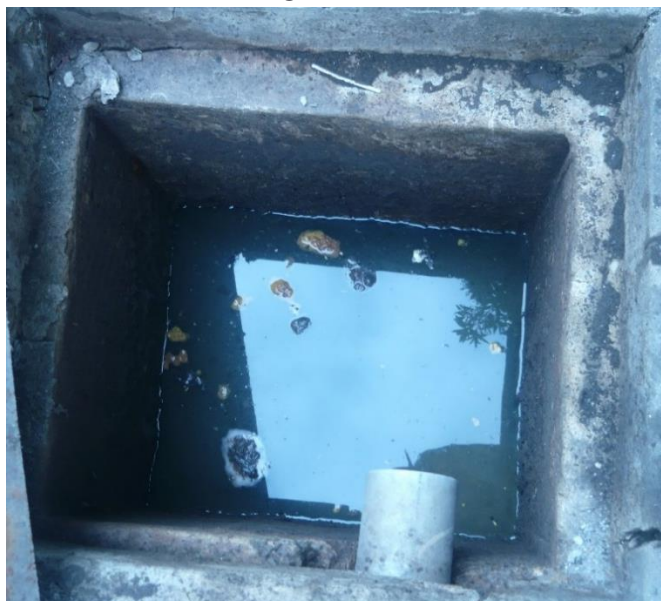
Figura 11.54 Se evidencia empozamiento de aguas servidas
