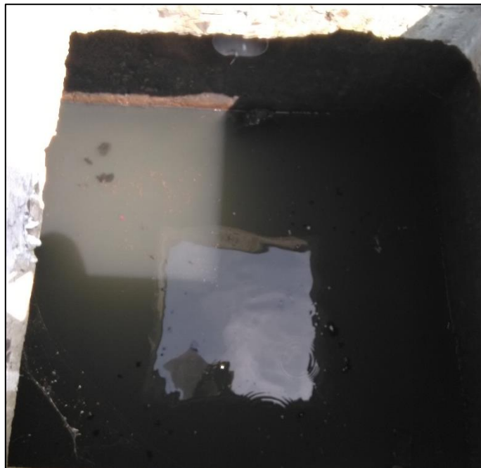
Figura 11.48 Se evidenció la presencia de peces en esta caja.
