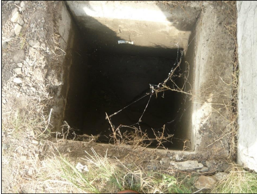
Figura 11.38 Caja de registro con tierra
