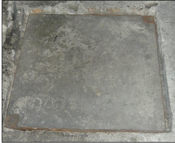
Figura 11.47 Difícil abrir caja
