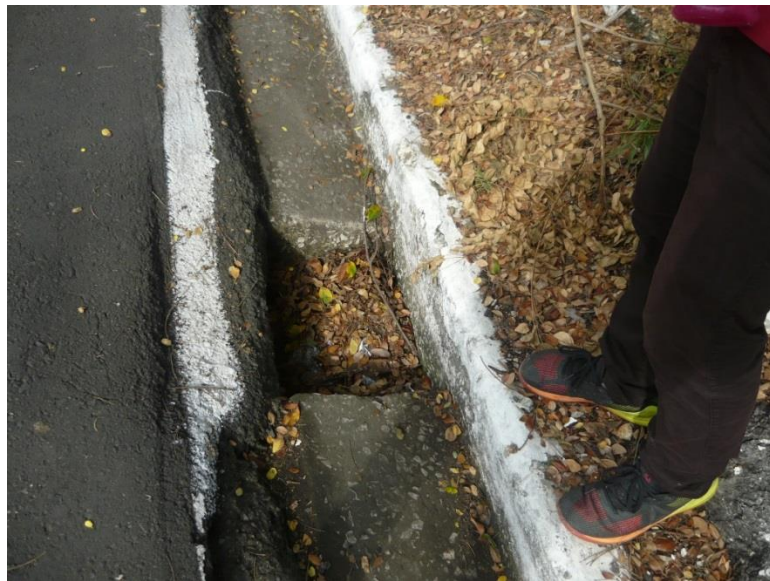
Figura 11.2 Sumidero obstaculizado por tierra
