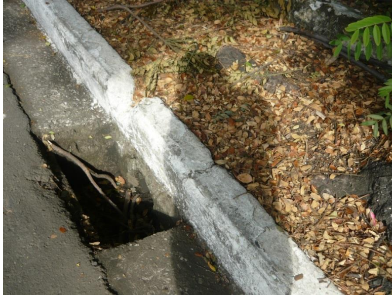
Figura 11.1 Sumidero obstaculizado por tierra y ramas de árboles
