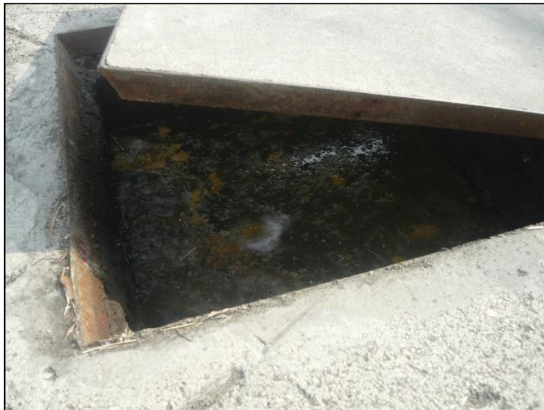
Figura 11.43 Caja de registro colapsada
