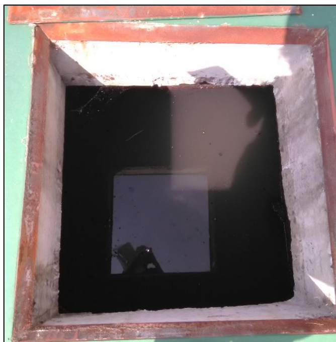
Figura 11.49 Acumulación de agua en la caja
