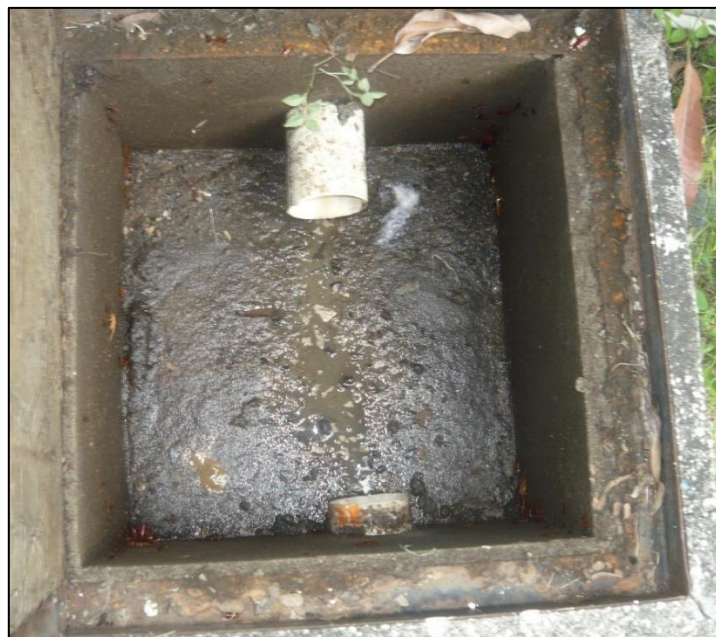
Figura 11.22 Acumulación de aguas servidas
