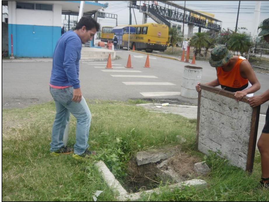
Figura 2.3 Caja de registro de AALL cerca de la entrada principal
