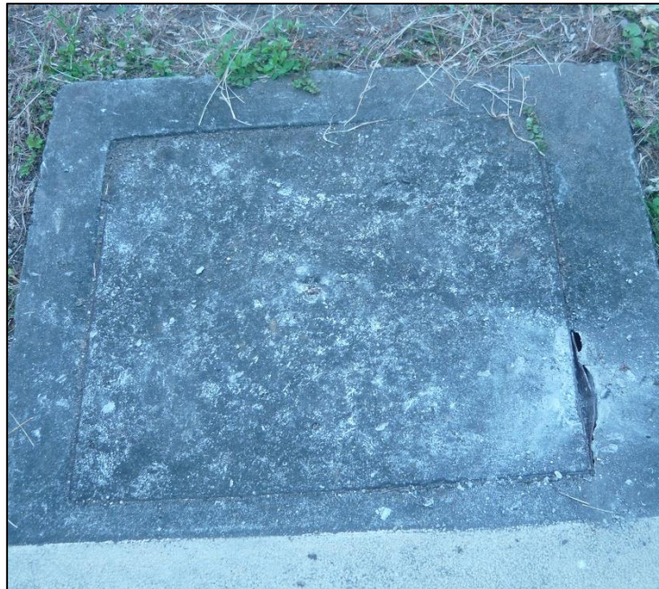
Figura 11.35 Junta de la tapa completamente selladas
