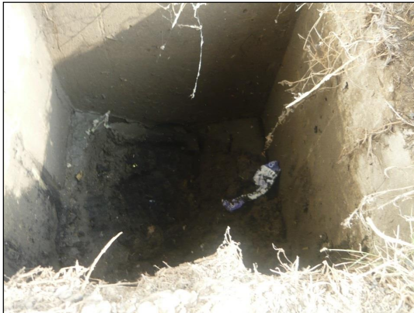
Figura 11.39 Caja de registro con presencia de tierra
