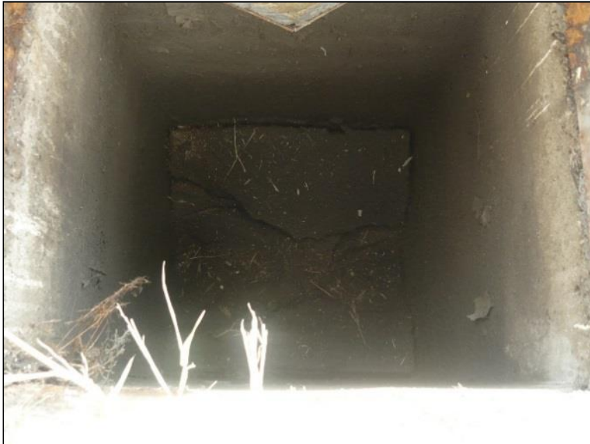
Figura 11.41 Caja de registro con presencia de tierra
