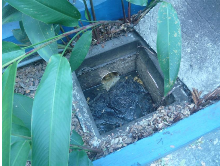
Figura 11.51 Caja de registro colapsada
