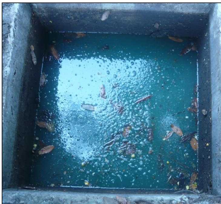
Figura 11.29 Empozamiento de aguas servidas
