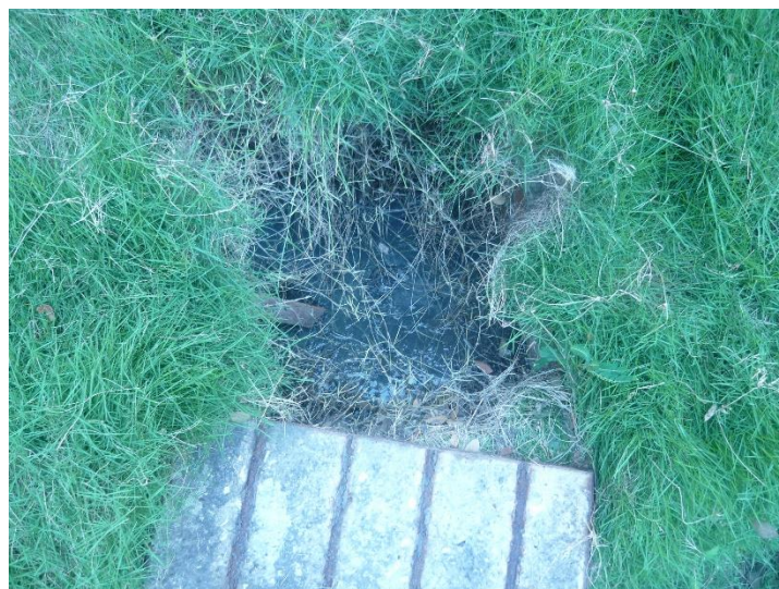
Figura 11.52 Caja de registro colapsada
