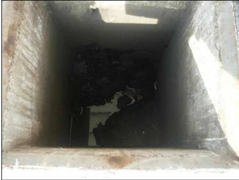
Figura 11.42 Caja de registro con tierra
