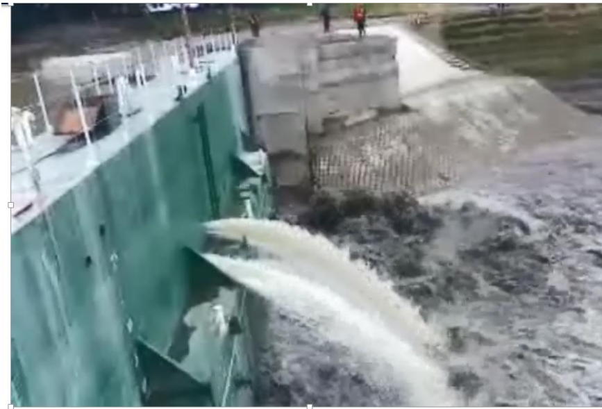
Figura N°3.2.- colocada la compuerta y con la carga de agua total, se colapsó o disparó la masa de suelos de la cimentación. También se observan caudales que se dejaron pasar por la compuerta para disminuir la carga que estaba erosionando progresivamente los suelos de cimentación.
