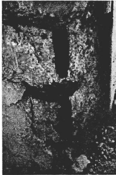
FIGURA 1.6.4. PILOTE DE HORMIGÓN CARBONATADO. CORROSIÓN GENERALIZADA SE OBSERVA.
