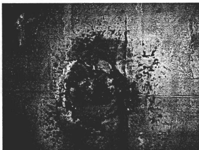
FIGURA 2.3.4. PRUEBA CON FENOLFTALEÍNA EN PANTALLA No. 20, LADO SUR, COTA + 2.400 MSNR, CARA INTERIOR
