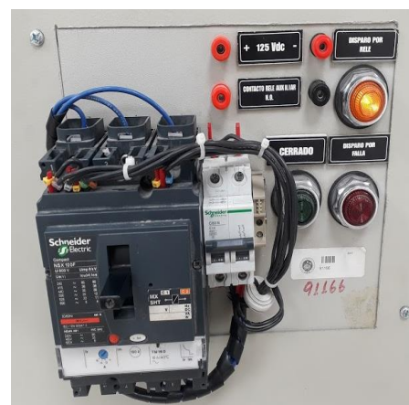
Figura 3.23 Disparo del interruptor del motor
