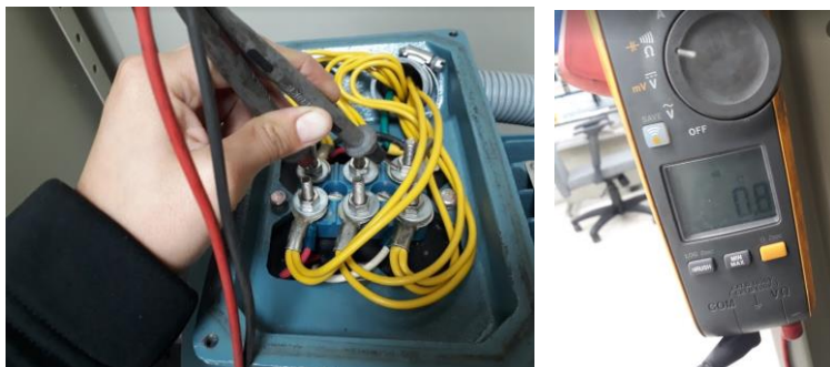
Figura 3.13 Medición de aislamiento en bobinas del motor trifásico
