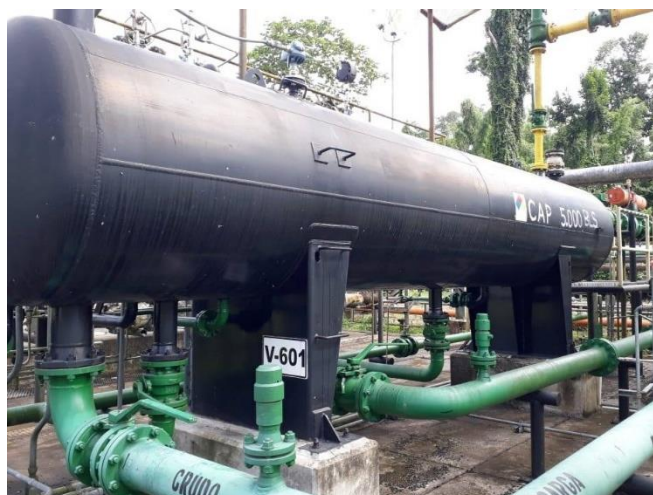
Figura 3.7 Separador Trifásico de la estación TPF (Petroamazonas EP, 2019)
