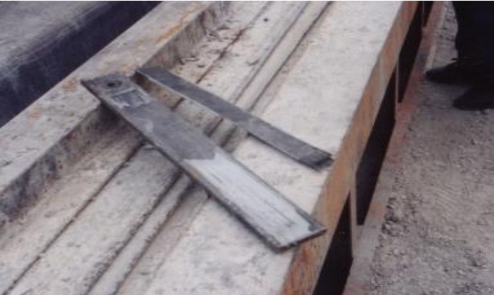
Foto 4.15. Falla Tipo a Tensión Ensayo Proyecto
