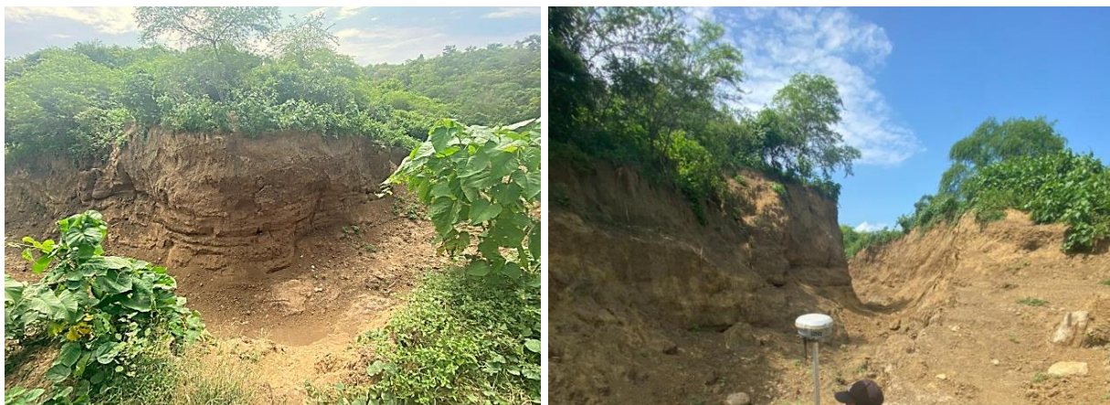
Figura 1.2 Zona de colapso del dique original. Fuente: Novillo R.; Stay, D. (2021)
