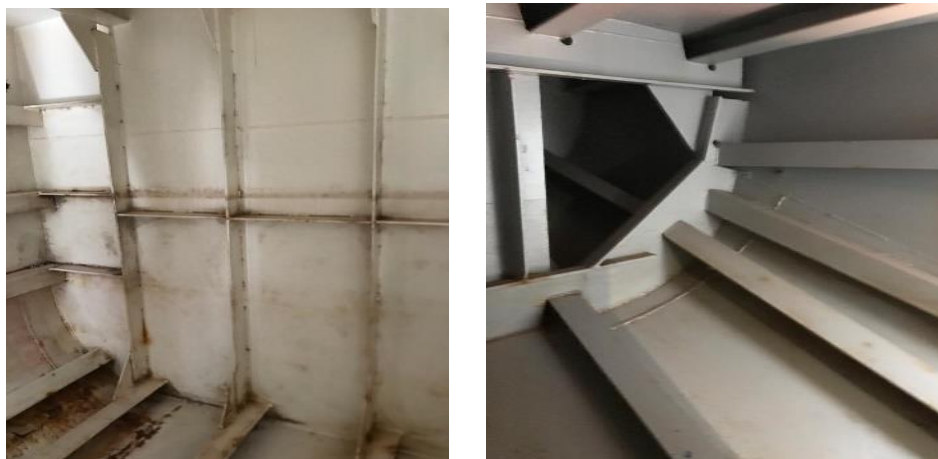
Figura 2.2 Detalles estructurales -visita técnica 06/11/2021 [FUENTE: Propia]
