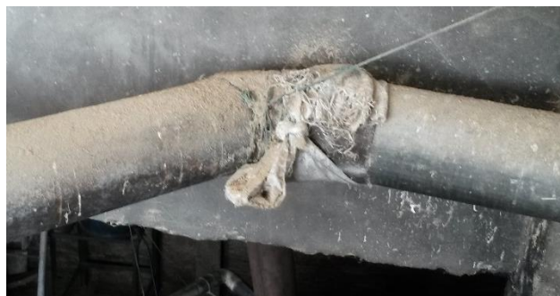
Gráfico 17 - Daños en las tuberías
