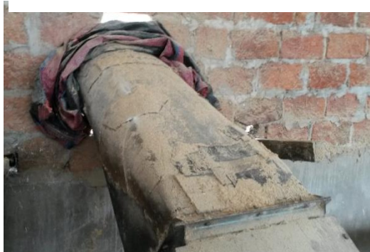
Gráfico 18 - Daños en el ducto
