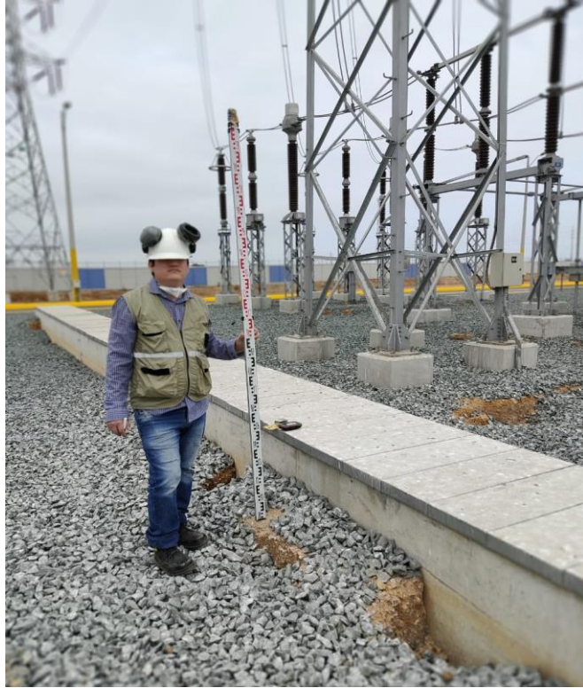
Anexo 9 Grietas originadas por asentamientos diferenciales
