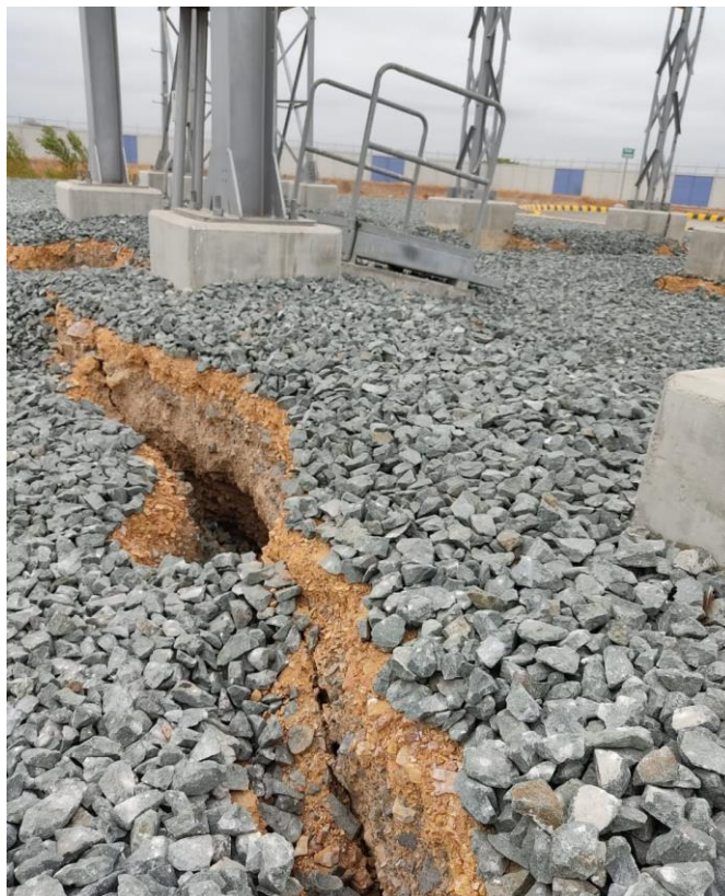
Anexo 8 Grietas originadas por asentamientos diferenciales
