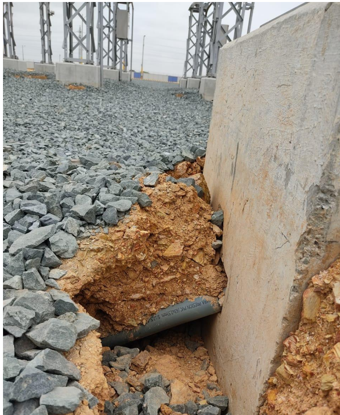
Anexo 10 Tuberías en peligro por asentamientos diferenciales
