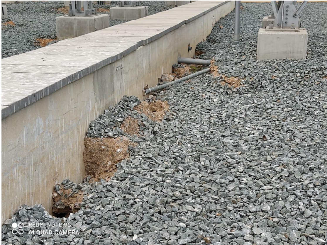
Anexo 7 Grietas originadas por asentamientos diferenciales
