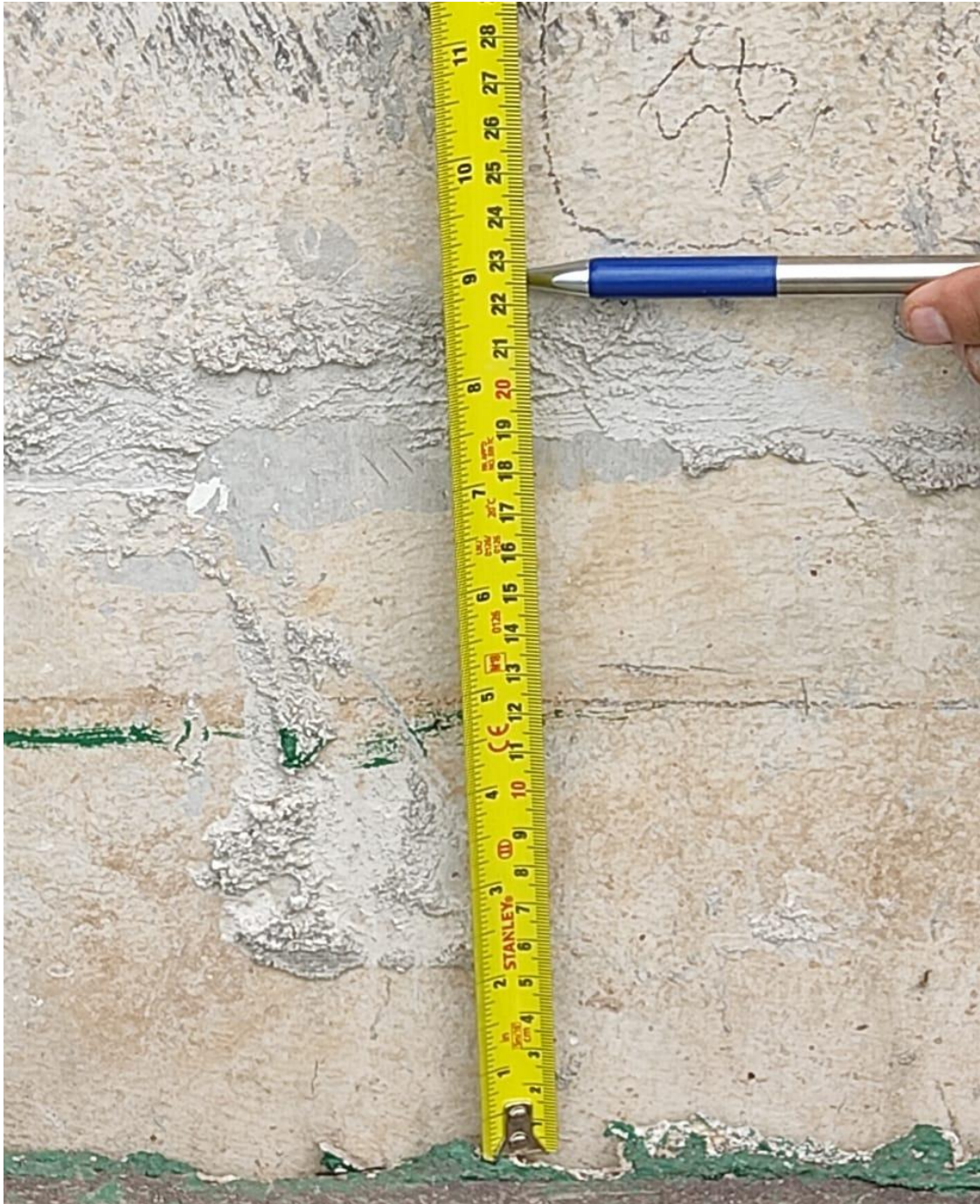
Anexo 11 Visualización física originadas por asentamientos diferenciales
