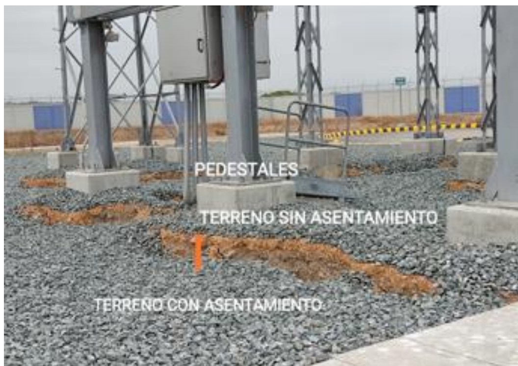
Figura 1.2 Asentamientos diferenciales alrededor de pórticos
