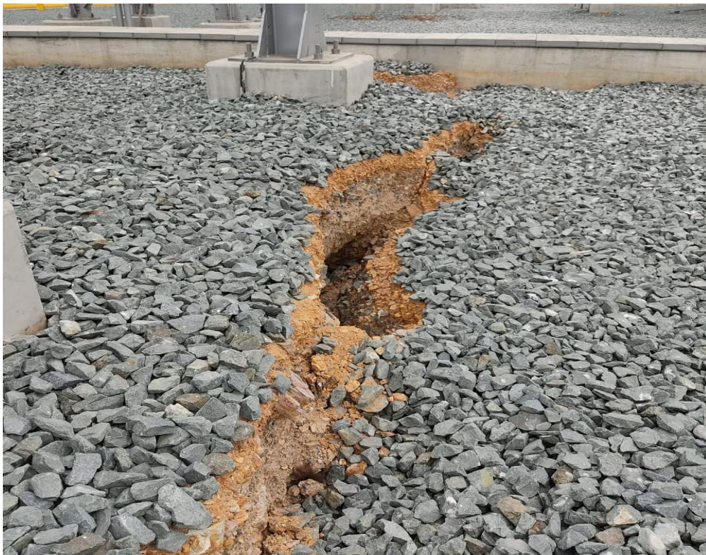
Anexo 6 Grietas originadas por asentamientos diferenciales
