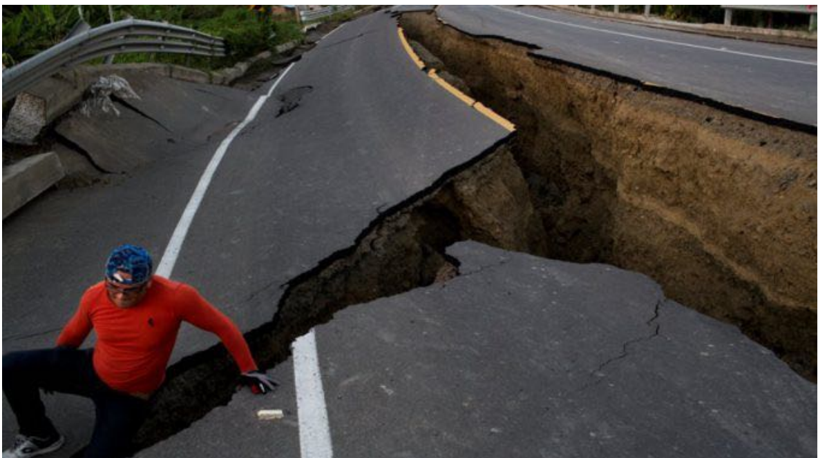
Ilustración 5. Terraplén de carretera en Manabí colapsado debido al Terremoto del 16 de abril de 2016 (Fuente: Diario La República).
