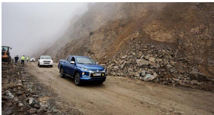
Figura 1: Deslizamientos en la vía Cuenca – Molleturo – El Empalme (Diario El Mercurio, 2021).
