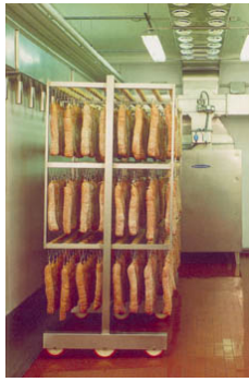
FIGURA 3.16: Cámara de secado – maduración
