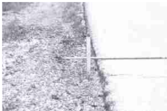
FOTO No. 4.27.- Falla Desnivel Carril/Espaldón – Severidad Alta
