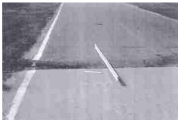
FOTO No. 4.46.- Falla Desplazamiento – Severidad Alta
