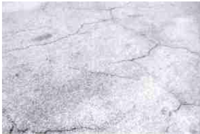
FOTO No. 2.1.- Fisura de Bajo Nivel
