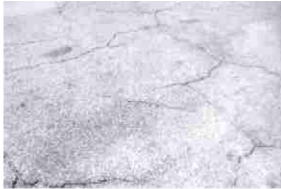
FOTO No. 4.7.- Falla Fisuramiento en Bloque – Severidad Baja
