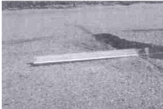
FOTO No. 4.10.- Falla Desnivel Localizado – Severidad Baja
