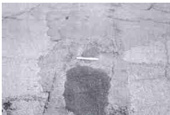
FOTO No. 4.33.- Falla Parche – Severidad Alta
