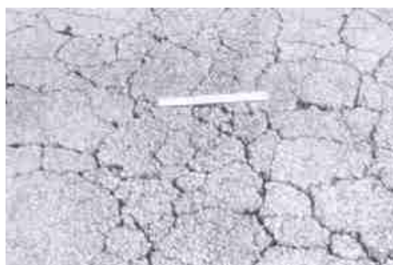
FOTO No. 4.3.- Falla Piel de Cocodrilo – Severidad Alta
