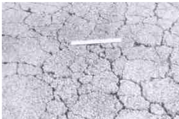
FOTO No.2.2.- Fisura de Alto Nivel
