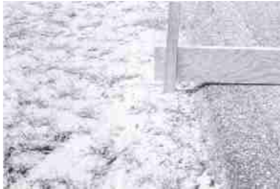
FOTO No. 4.25.- Falla Desnivel Carril/Espaldón – Severidad Baja
