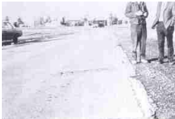
FOTO No. 4.11.- Falla Desnivel Localizado – Severidad Media
