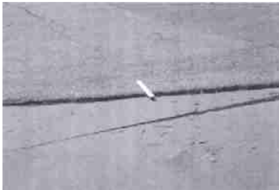
FOTO No. 4.45.- Falla Desplazamiento – Severidad Media
