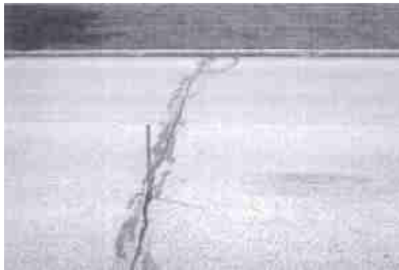
FOTO No. 4.29.- Falla Fisuramiento Longitudinal y/o Transversal – Severidad Media
