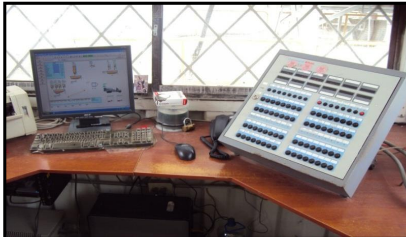
Ilustración 7. 9 Panel de Control Planta HOLCIM.
