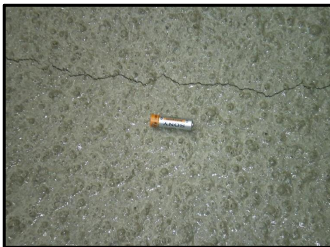
Ilustración 8. 22 Formación de Fisura por Contracción y Secado, Tomado de la Presentación: HCR Evolución y Nuevos Horizontes - Ing. Miguel A. Golik.
