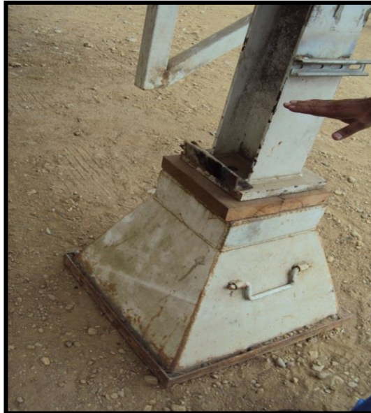
Ilustración 7. 7 Base Usada en la Planta Móvil de HOLCIM.
