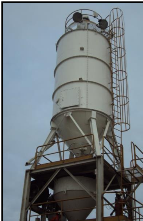
Ilustración 7. 5 Silos de Almacenamiento de Cemento y en la parte Inferior Silos de Aditivos.
