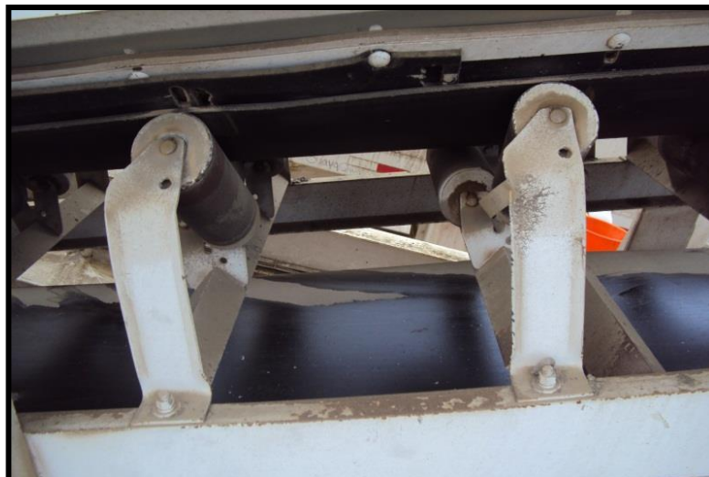
Ilustración 7. 18 Rodillos / parte de la Cinta Transportadora Planta Móvil HOLCIM.
