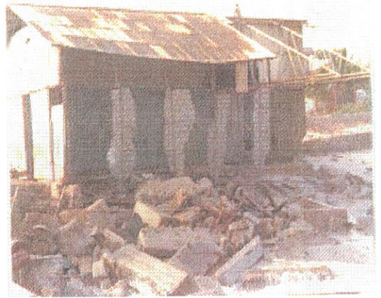
Figura 3.13a.- Daños ocasionados por El Niño 1982-1983 en el malecón de La Libertad
