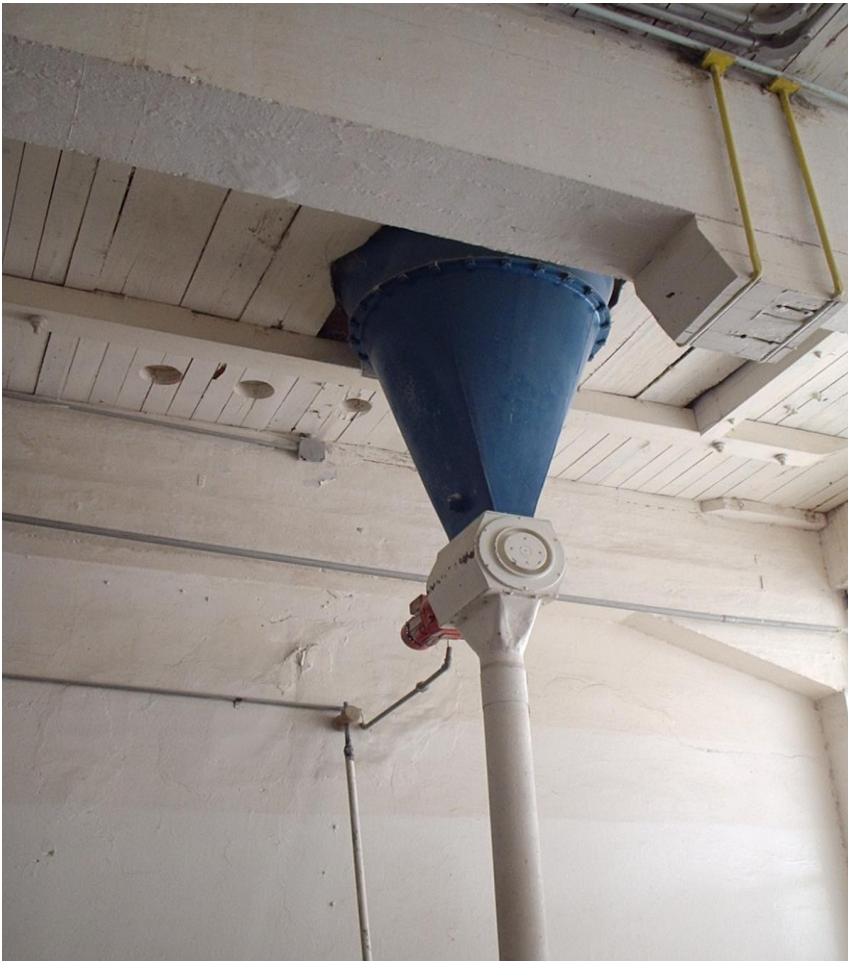
Sistema mecánico de recuperación de polvos a utilizar
