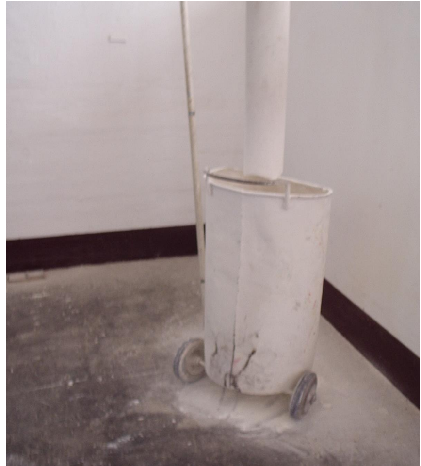
Captación inadecuada de polvos en circuito abierto, provoca emisiones fugitivas
