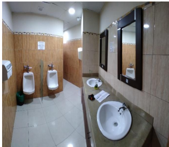
Figura 6.- Urinarios ubicados en baños de la planta baja del edificio de rectorado. (Autoría propia, 2021)
