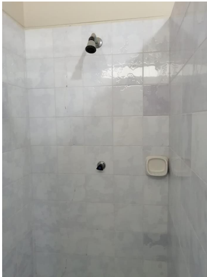
Figura 2.2-7 Ducha actual presente en el Edificio Decanato FICT [Fuente (Autor Propio, 2021)].
