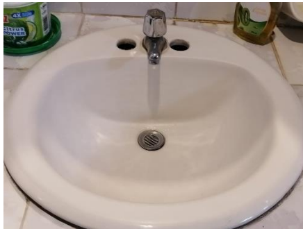
Figura 3.1-8 Grifería presente en el Edificio Decanato FICT [Fuente (Autor Propio, 2021)].
