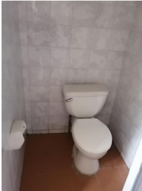
Figura 2.2-8 Inodoro actual del Edificio Decanato FICT [Fuente (Autor Propio, 2021)].
