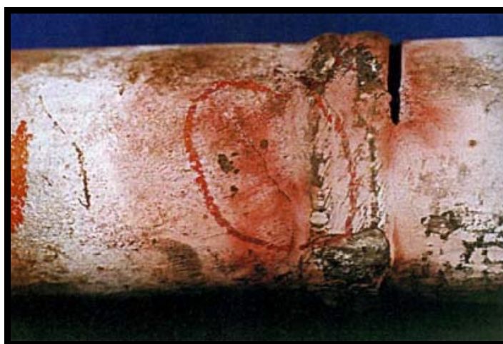
FIGURA 1.6. ASPECTO DE LA GRIETA POR CORROSIÓN BAJO ESFUERZO SOBRE LA SUPERFICIE EXTERNA. (FUENTE: GUIA NALCO PARA EL ANALISIS DE FALLA EN CALDERAS)
