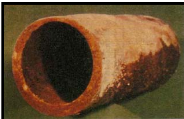
FIGURA 1.7. ADELGAZAMIENTO DE LA PARED DEBIDO A LA CORROSIÓN POR CENIZA DEL COMBUSTOLEO. (FUENTE: GUIA NALCO PARA EL ANALISIS DE FALLA EN CALDERAS)
