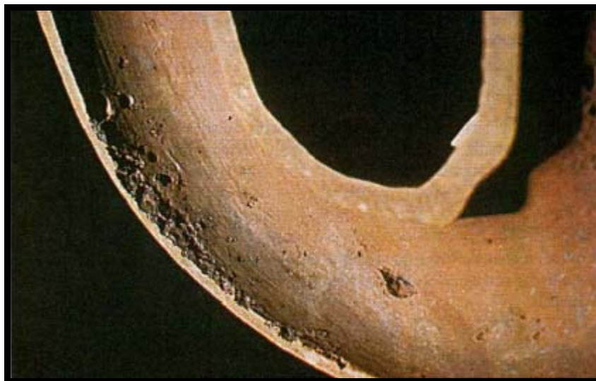
FIGURA 1.5. PICADURAS DEBIDO AL OXIGENO EN UN TUBO DE SOBRECALENTADOR. (FUENTE: GUIA NALCO PARA EL ANALISIS DE FALLA EN CALDERAS)
