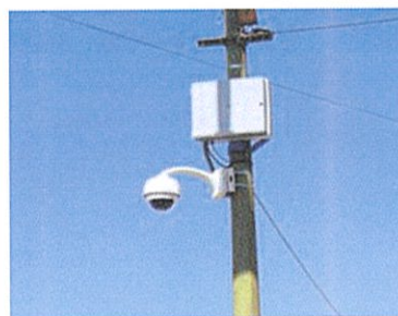
Figura 3. Cámara tipo domo
