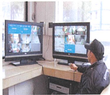
Figura 2. Centro de Control
