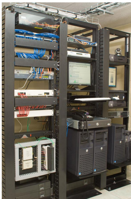
Figura 1.1: Rack de servidores
