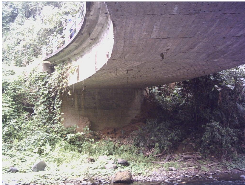
Vista inferior del puente con mucha vegetación (matorrales) y material transportado por el río aguas arriba.
