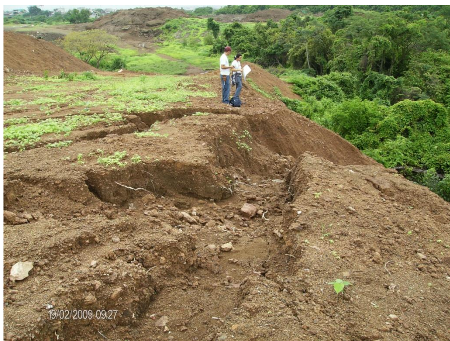
Figura 5: Erosiones provocadas por las antiguas canteras
