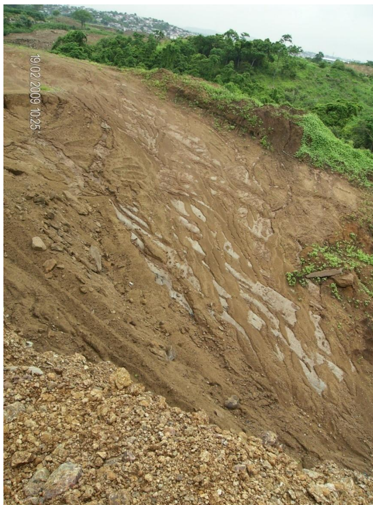
Figura 6: Inestabilidad de Taludes
