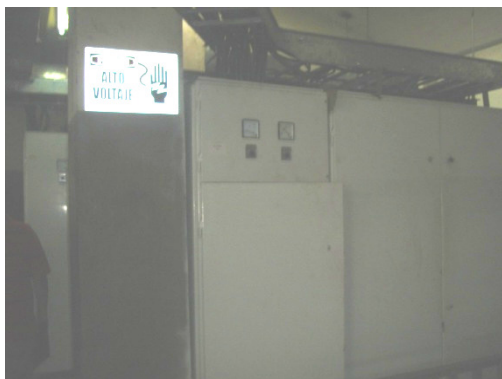
Fig. 1-9 Panel de Transferencia del Generador marca SDMO.
