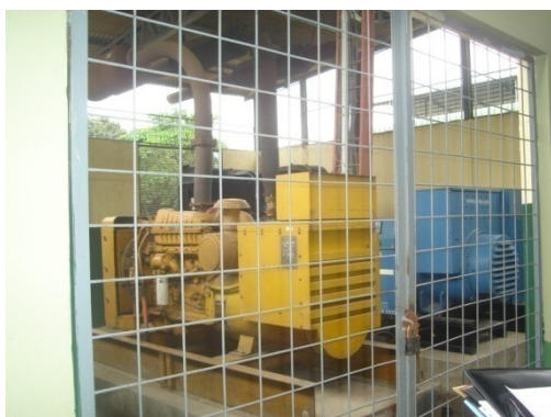
Fig. 1-6 Vista de los dos generadores.
