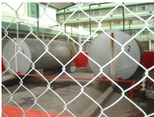
Fig. 1-13 Central de Combustibles.
