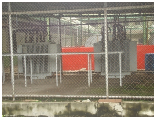
Fig. 1-12 Cuarto de Transformadores.
