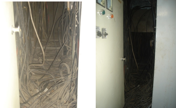
Fig. 1-11 Necesidad de Rediseño en Arreglo de Cables Eléctricos.
