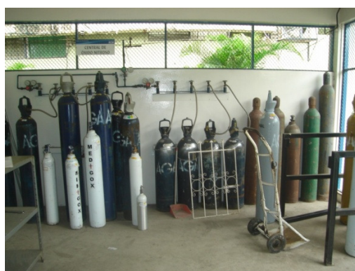
Fig. 1-3 Central de Óxido Nitroso.
