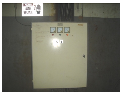
Fig. 1-8 Panel de Transferencia del Generador marca Caterpillar.
