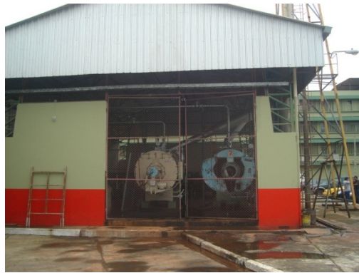
Fig. 1-14 Cuarto de Máquinas con los calderos marca York Shipley.
