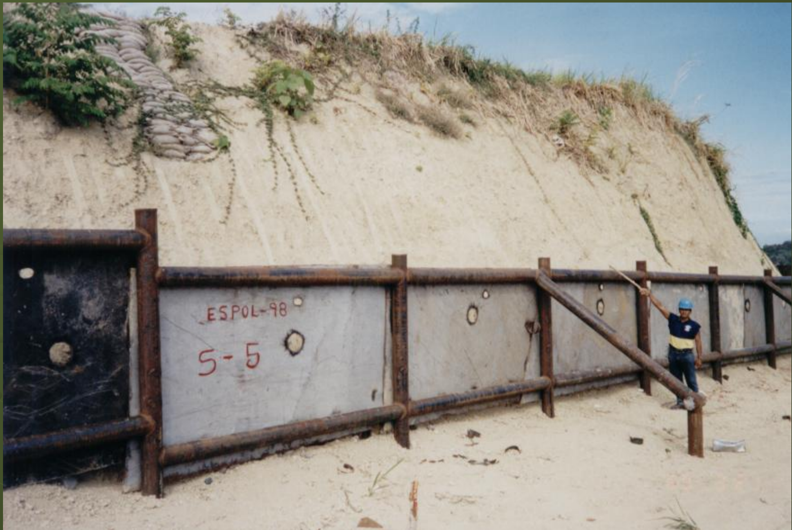
Pilotes de acero y planchas metálicas para sostenimiento de talud en el terminal Balao
