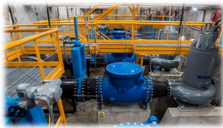
Figura 8 Estación de bombeo de aguas residuales Pradera Nueva
