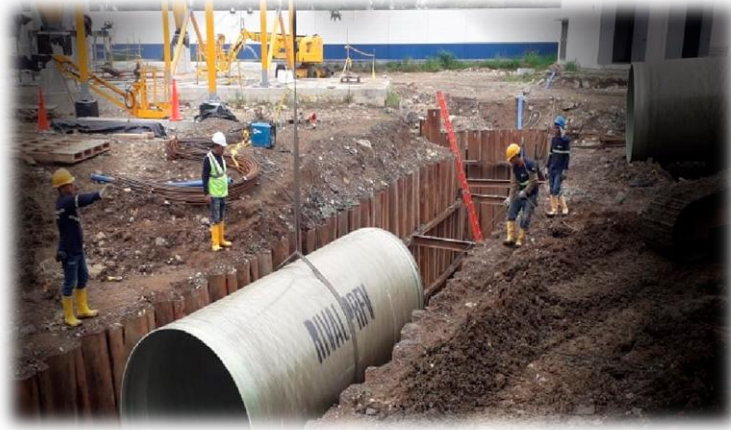
Figura 10 Red de tuberías para la planta de Tratamiento Las Esclusas
