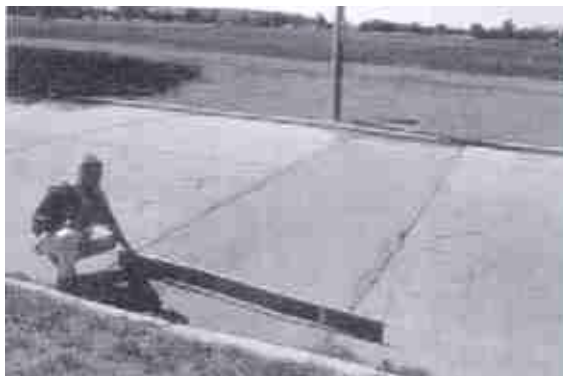
FOTO No. 4.32.- Falla Parche – Severidad Media
