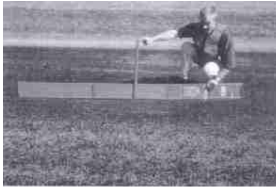
FOTO No. 4.16.- Falla Depresión – Severidad Baja
