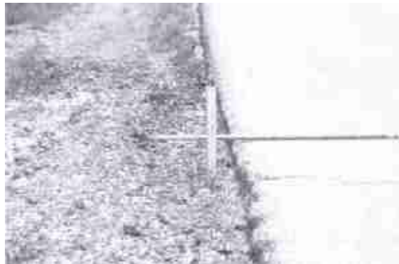
FOTO No. 4.27.- Falla Desnivel Carril/Espaldón – Severidad Alta
