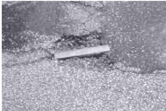
FOTO No. 4.35.- Falla Bache – Severidad Baja
