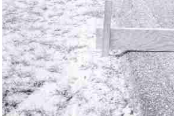
FOTO No. 4.25.- Falla Desnivel Carril/Espaldón – Severidad Baja
