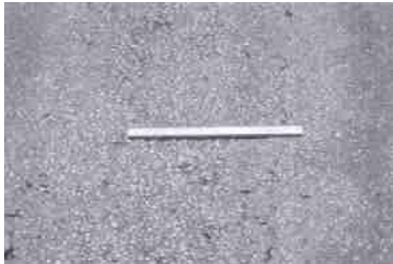
FOTO No. 4.52.- Falla Intemperismo – Severidad Media
