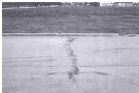
FOTO No. 4.30.- Falla Fisuramiento Longitudinal y/o Transversal – Severidad Alta
