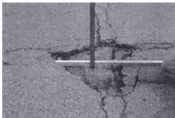
FOTO No. 4.36.- Falla Bache – Severidad Media
