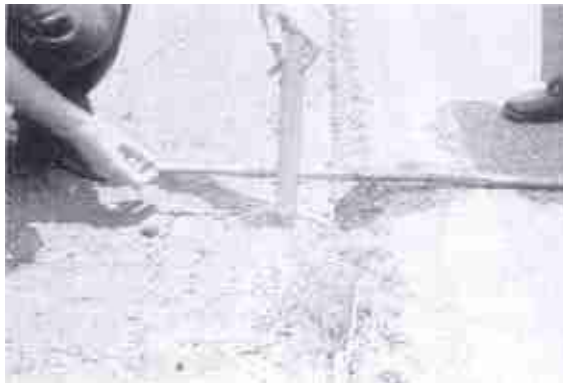
FOTO No. 4.26.- Falla Desnivel Carril/Espaldón – Severidad Media
