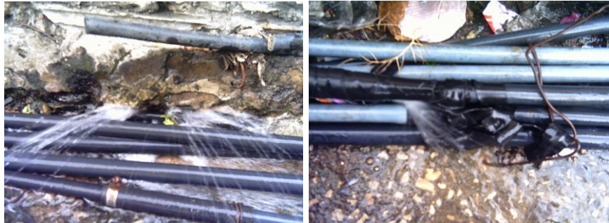
Foto 7 Callejón 12 de octubre, fugas visibles cada 2 m, roturas de mangueras
