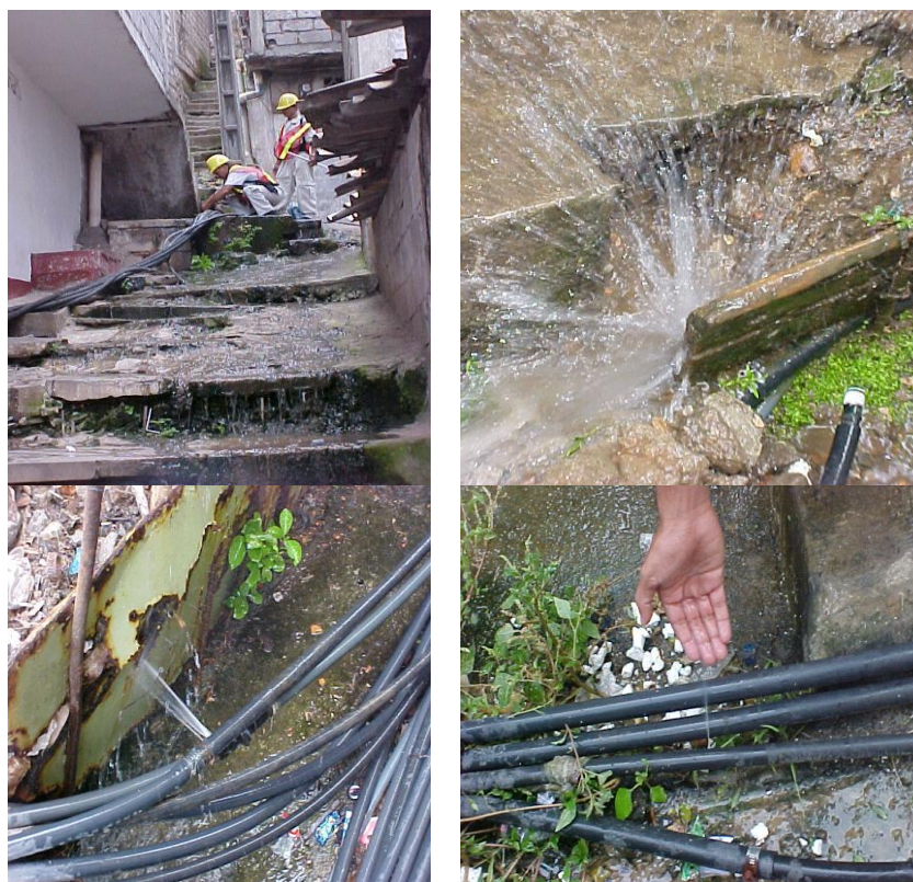
Foto 10 En el 9no callejón se presentan fugas visibles debido a las malas uniones
