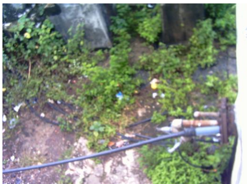
Foto 13 Conexión clandestina de 2", ubicadas en los predios donde se encuentra el Tanque Elevado y la Cisterna Alta.
