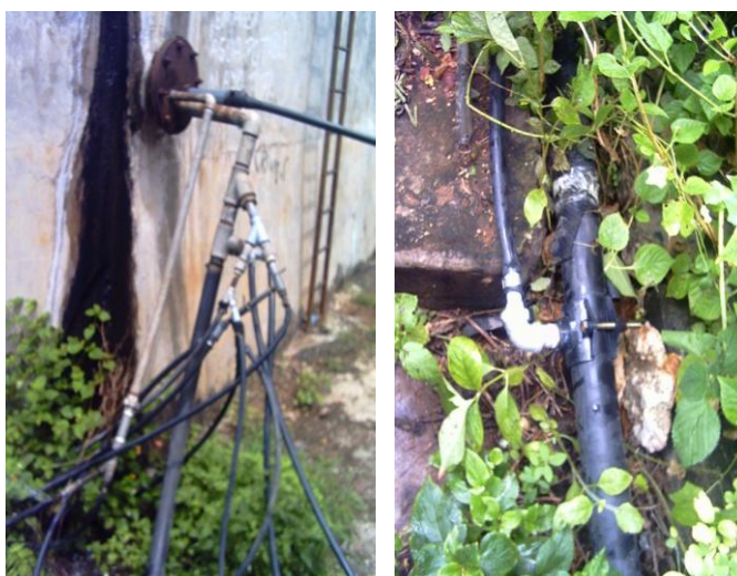
Foto 12 Conexiones clandestinas ubicadas en el Tanque Elevado de 10 m3.
