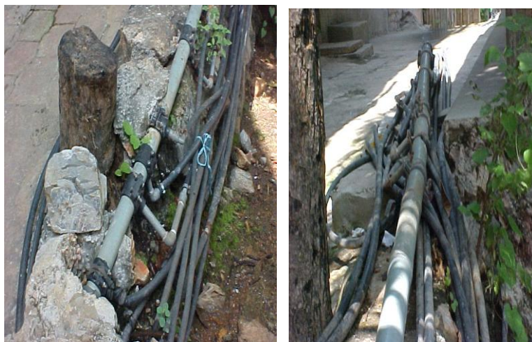
Foto 21 En el 9no callejón se encontró la conexión ilegal de 30 mangueras de ½” a una tubería P.V.C de 2”.
