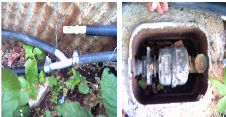
Figura 16. Medidores en mal estado.
