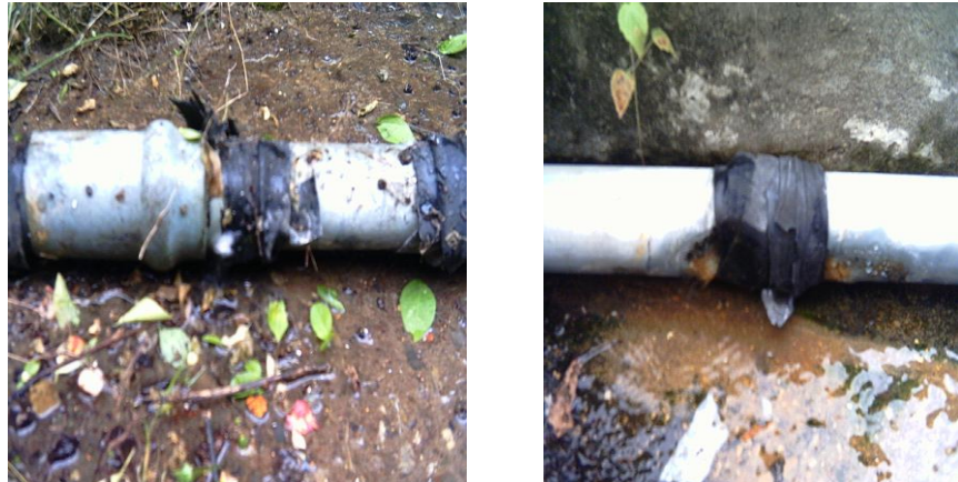
Foto 3 Fugas existentes causados por las malas uniones
