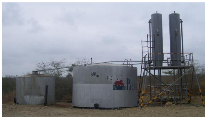
FIGURA 5.3 TANQUES DE ALMACENAMIENTO EN LAS SUBESTACIONES
