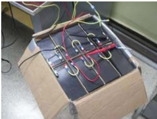
Figura 5 Banco de Baterías
