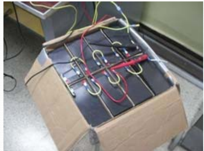
8 BATERIAS: 12 VOLTIOS, 7 AMPERIOS
