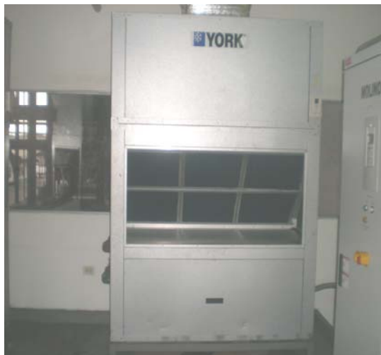
Fig. # 4.10 Unidad Aire acondicionado.
