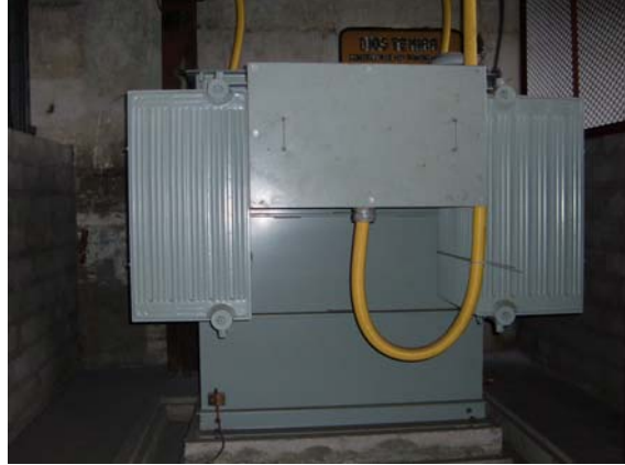
Fig. # 4.8 Transformador de aislamiento.
