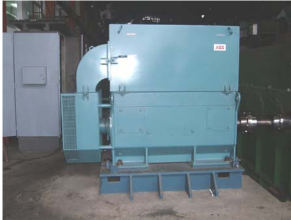
Fig. 4.11 Motor eléctrico de molinos.
