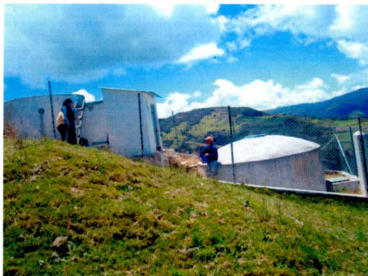
Foto 8: Tanque de reserva y Planta de tratamiento de agua de la comunidad de Bulán
