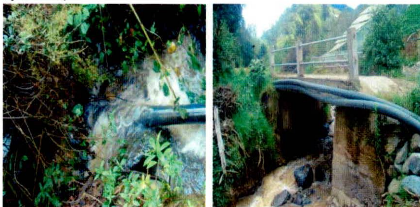
Foto 10: Captación sin obra de toma y conducción de politubo. Canal Chiguín - Sumán
