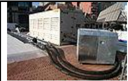
La maquina enfriadora junto al buffertank y conectada a la pista de hielo
