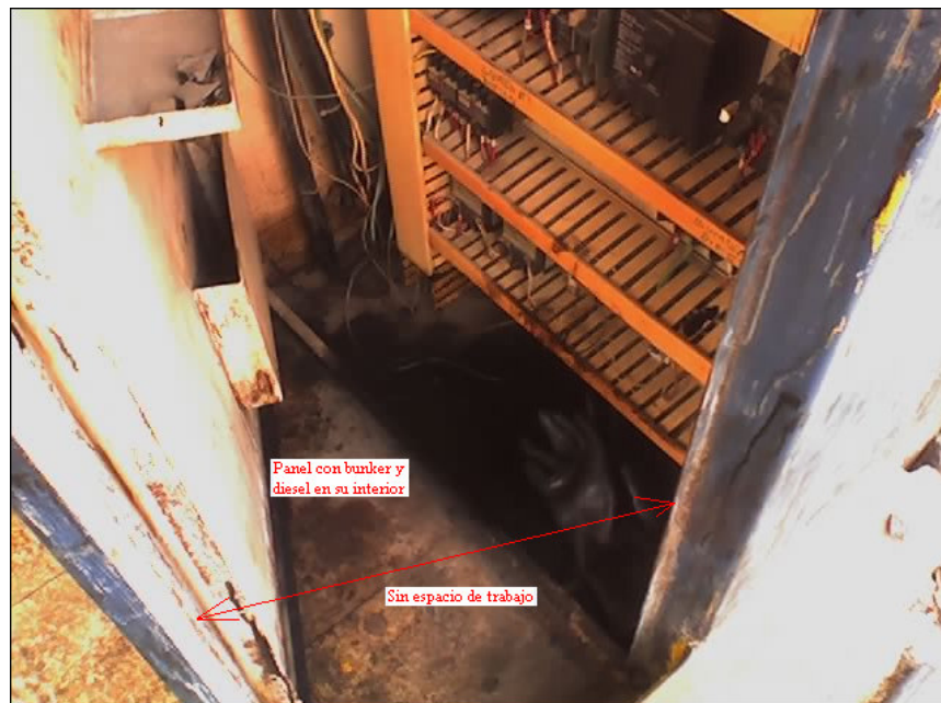
Figura 4.2. Estado interno del panel de bombas de combustible.
