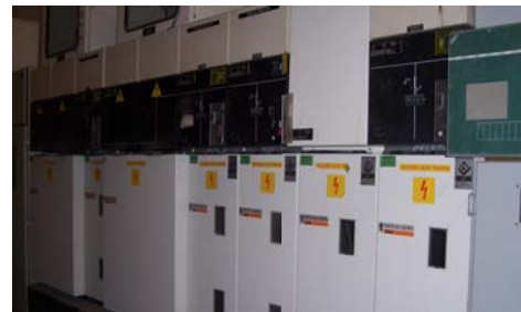
Conjunto de celdas con Seccionador Fusible.
