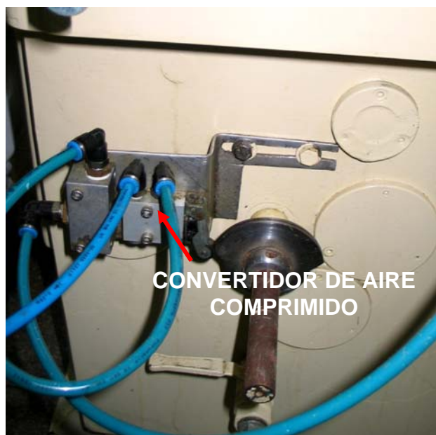
FIGURA 4.12. ENVOLVEDORA DE CALDOS (DESPUES)
