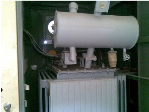
Figura #3. Transformador 500KVA subestación primaria
