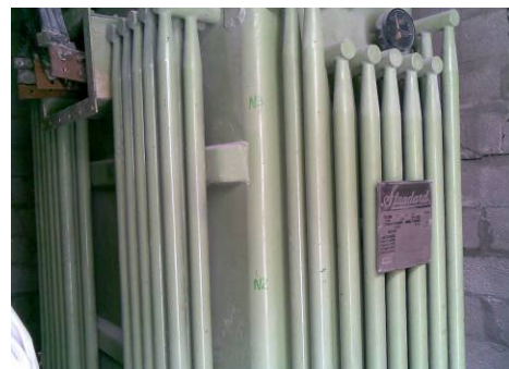
Figura #24 Transformador de Potencia de la subestación “Planta de Cal”
