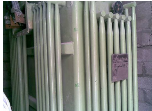
Figura #5. Transformador 750KVA subestación Planta de Cal
