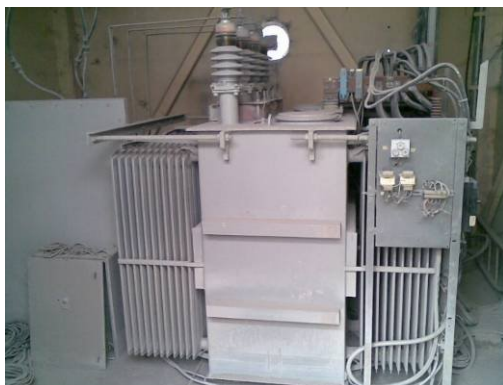
Figura #13 Transformador de Potencia de la subestación “Trit. Secundaria”
