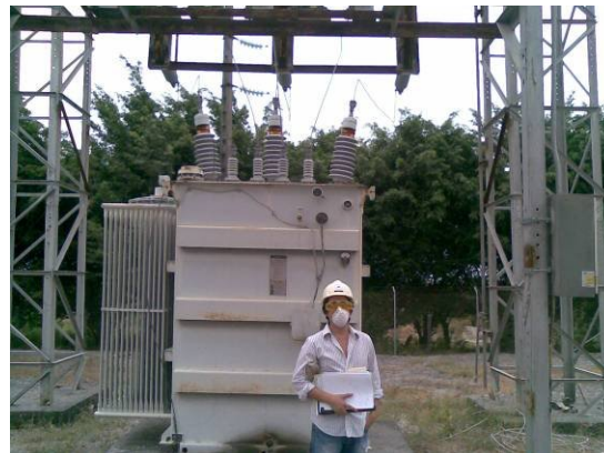
Figura #11 Transformador de Potencia de la subestación Principal
