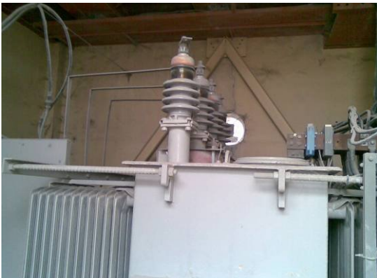
Figura #4. Transformador 2000KVA subestación secundaria
