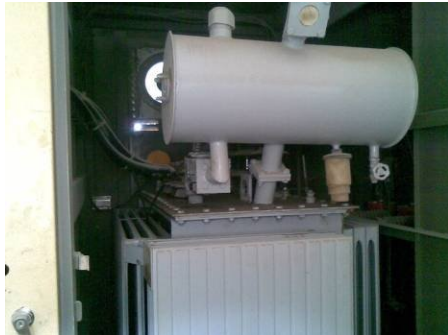
Figura #12 Transformador de Potencia de la subestación “Trituración primaria”
