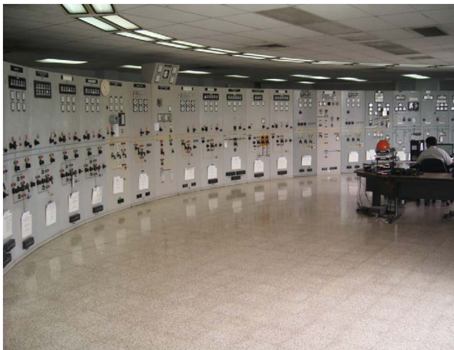
Fig. 20 Sala de control S/E Pascuales
