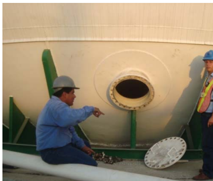
Fuente: Refinería La Libertad, PETROINDUSTRIAL FIGURA 4.4. ENTRADA DE HOMBRE DEL TANQUE N° 31
