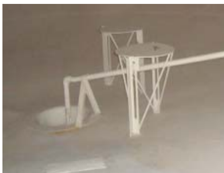
Fuente: Refinería La Libertad, PETROINDUSTRIAL FIGURA 4.2.MESA DE AFORO Y TINA DE DRENAJE
