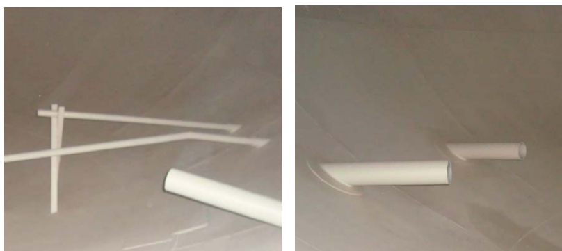
Fuente: Refinería La Libertad, PETROINDUSTRIAL FIGURA 4.6. TUBERÍAS EN EL INTERIOR DEL TANQUE
