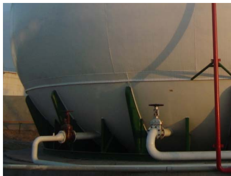
Fuente: Refinería La Libertad, PETROINDUSTRIAL FIGURA 4.5. TUBERÍA DE ENTRADA Y SALIDA DEL TANQUE N° 31
