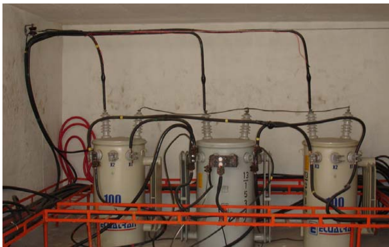
FIGURA 3 - 05: TRANSFORMADORES EN CENTRO DE TRANSFORMACIÓN
