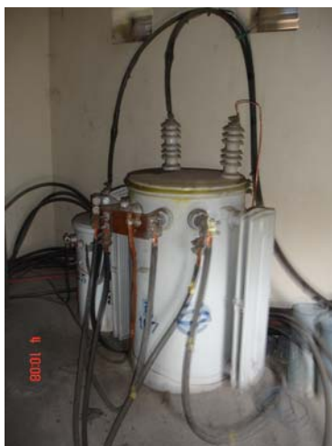
b. Transformador de distribución
