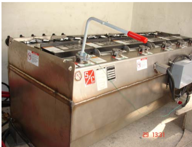
FIGURA 3 – 14: INTERRUPTOR DE DISTRIBUCIÓN SUBTERRÁNEA VISTA
