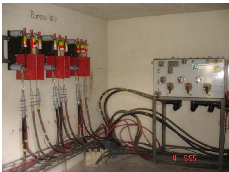
a. Conductores, Switch y fusibles
