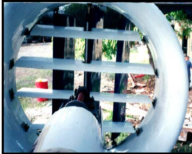
Foto 3.10.- Ensamble de sistemas de control
