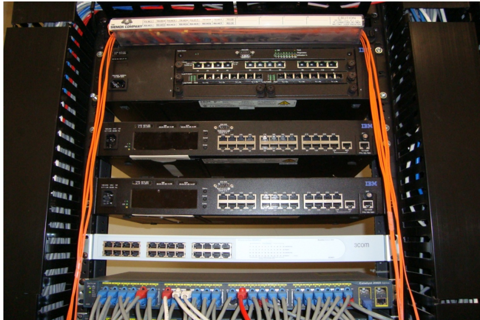
Figura 3.20. Cableado tipo UTP y fibra óptica.
