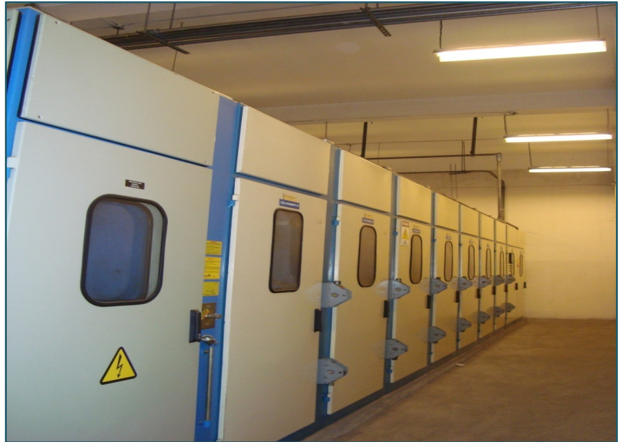
Figura 1.1. Celdas eléctricas de distribución.
