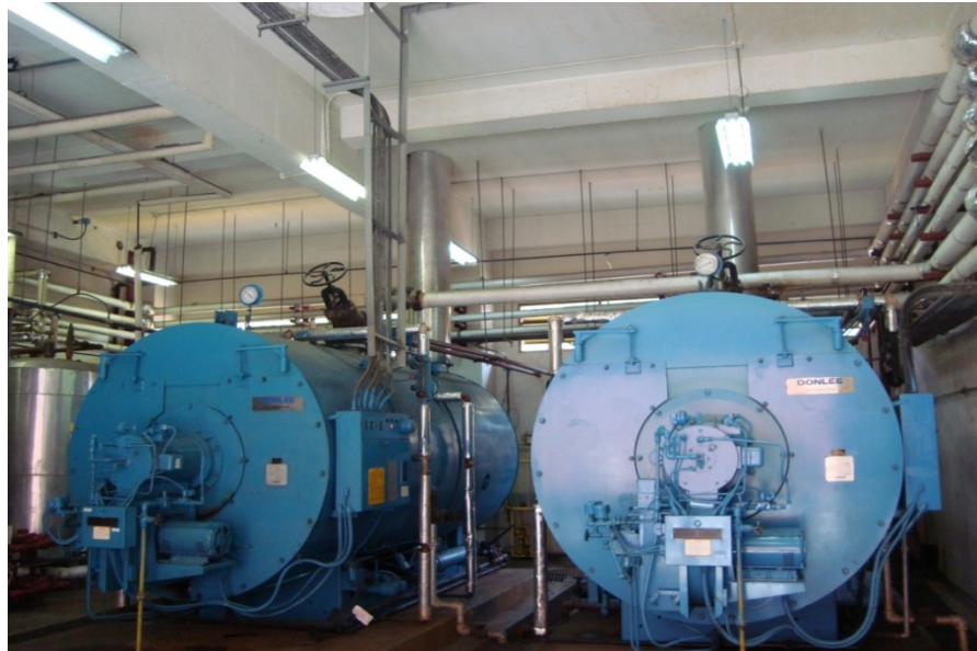
Figura 4.26. Calderos piro-tubulares York Shipley de 250HP.
