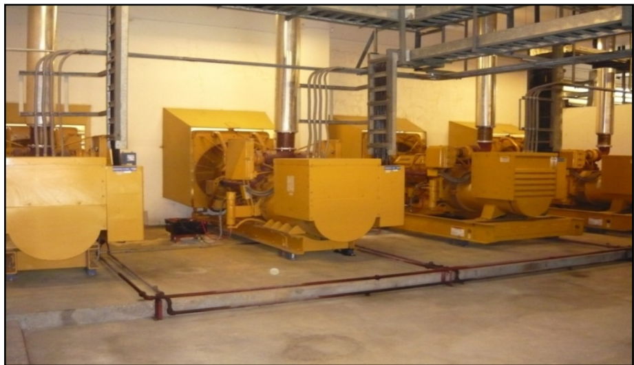
Figura 1.8. Grupos electrógenos A y B.
