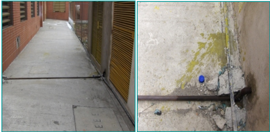
Figura 1.11. Tubería de combustible diesel del G6.
