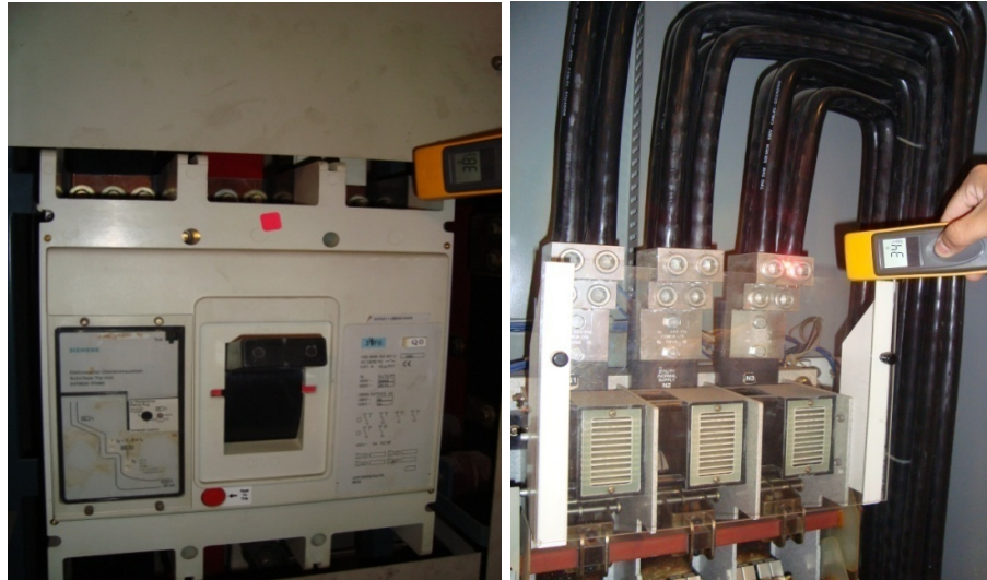
Figura 1.3. Temperaturas en tablero principal y TTA 2.
