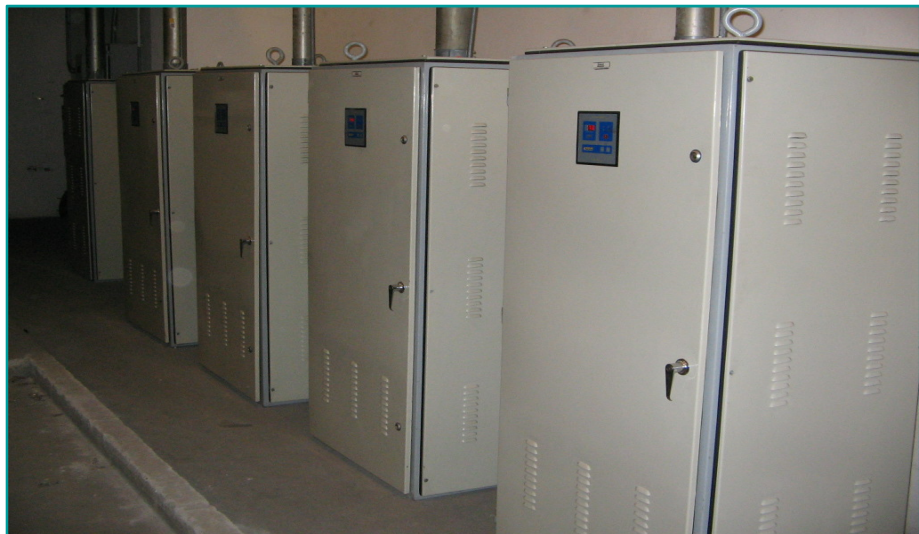
Figura 1.7. Bancos de capacitores del HRGE.
