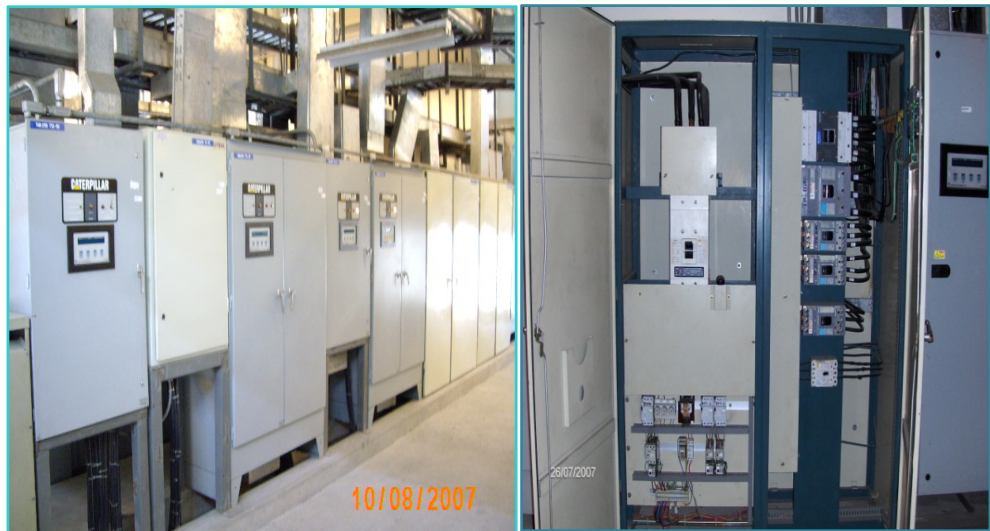
Figura 1.5. Tableros de Transferencia Automática y breakers principales.
