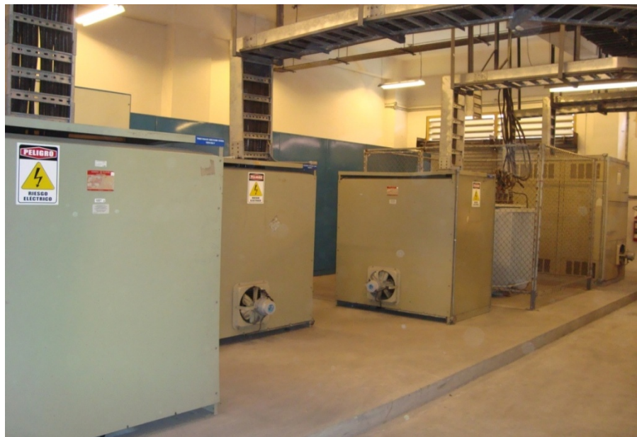
Figura 1.2. Transformadores del sistema eléctrico.
