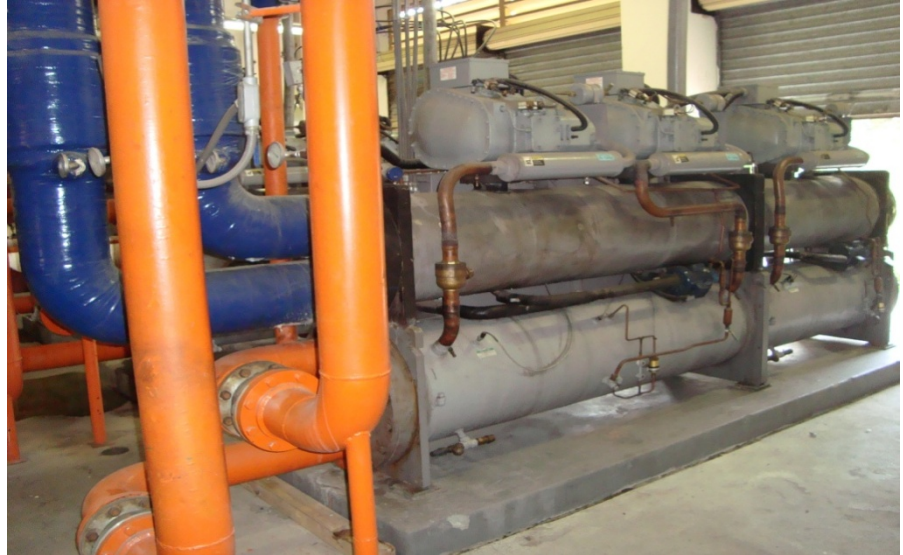
Figura 4.28. Equipos de refrigeración chillers
