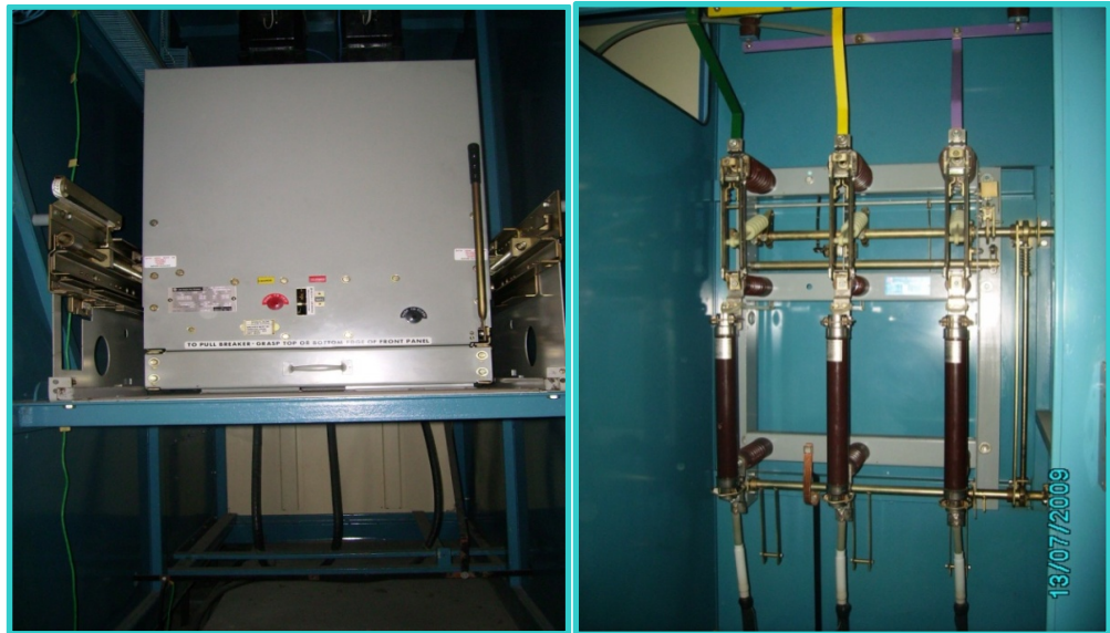
Figura 1.6. Breaker G.E. Type VB1 y protecciones de media tensión.
