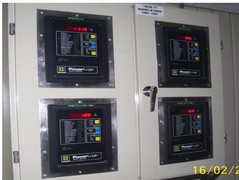
FIGURA 5.4 Medidores Power Link
