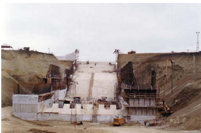
Fotografía 2.3.- La fotografía muestra el aliviadero de la Presa San Vicente. (Fuente: CEDEGE, presentación proyecto: Complejo Hidráulico San Vicente, página 3)
