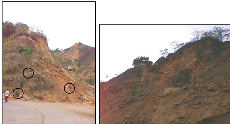
Fig. 1.8. Laderas de explotación sin medidas de control de riesgo.
